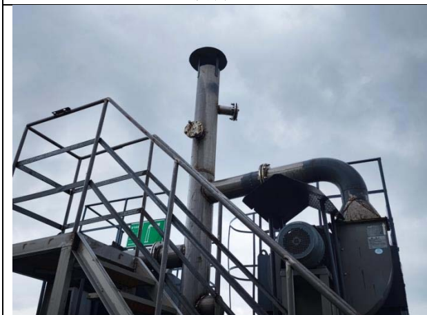
投料粉尘布袋除尘器及排气筒（DA001）
