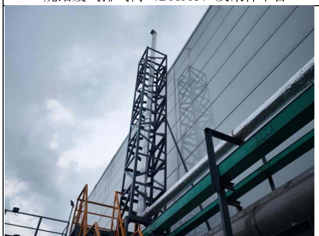
包装废气排气筒（DA006）及采样平台
