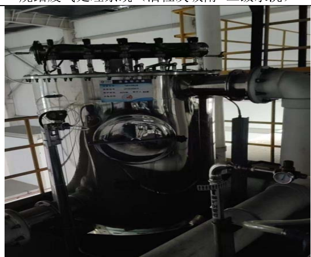
包装废气处理系统（布袋除尘器）
