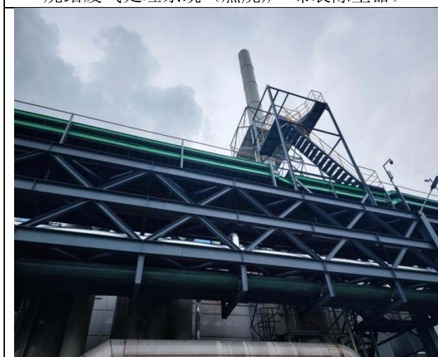
烧结废气排气筒（DA005）及采样平台
