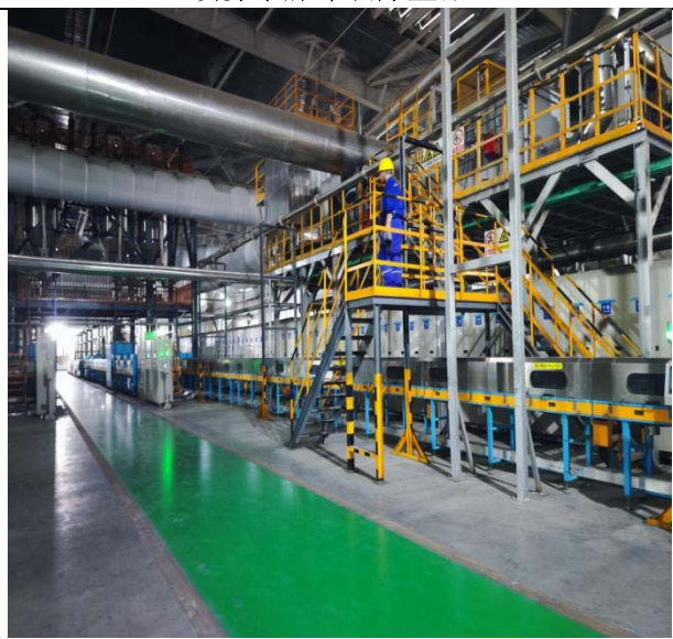
烧结辊道窑及废气输送管网
